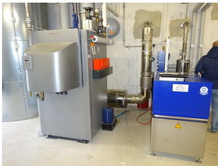
Abbildung 25: Wärmeerzeuger in der Heizzentrale des Wärmenetzes "Am Haidplatz" (BHKW rechts, Erdgaskessel links)
