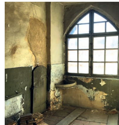
Feuchtschäden an den Innenwänden mit Rissen im Putz
